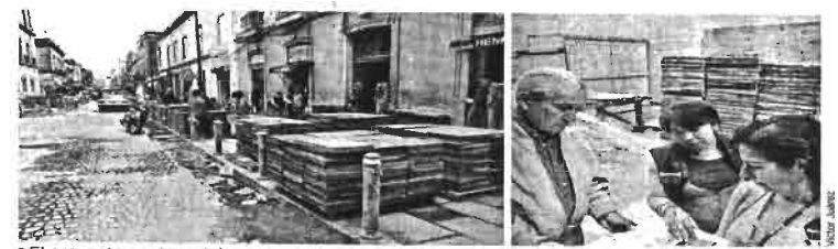
El proyecto contemplaba un andador completo, pero se instalan boyas para un carril vehicular.
