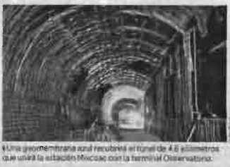
Una geomembrana azul cubren el túnel de 4.6 kilómetros que unirá la estación Mixcoac con la terminal Observatorio.
