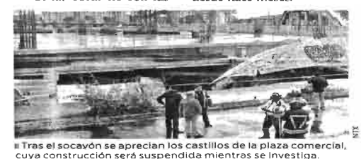
Tras el socavón se aprecian los castillos de la plaza comercial, cuya construcción será suspendida mientras se investiga.
