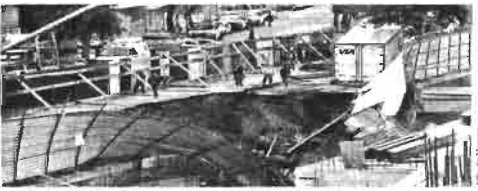
El hundimiento mide más de 7 metros de ancho por 30 de largo y 10 metros de profundidad.
