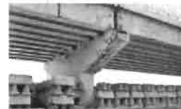
DISTRIBUIDOR vial, con grietas.
