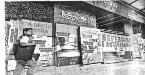
La construcción en Av. México Coyoacán 281 incumple el mínimo de área libre.
