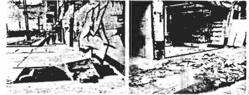
Vecinos del Primer Cuadro reportan las zanjas que hallan.
