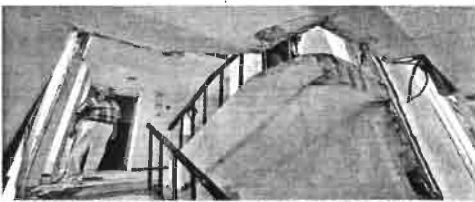
El edificio tiene escaleras separadas del piso, afectación en columnas, traveses, muros de carga y fachadas.
