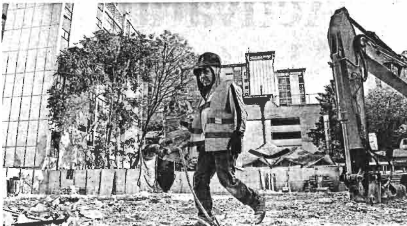
Con maquinaria pesada ya se comienza la excavación para los cimientos/FOTOS: DANIEL GALEANA
