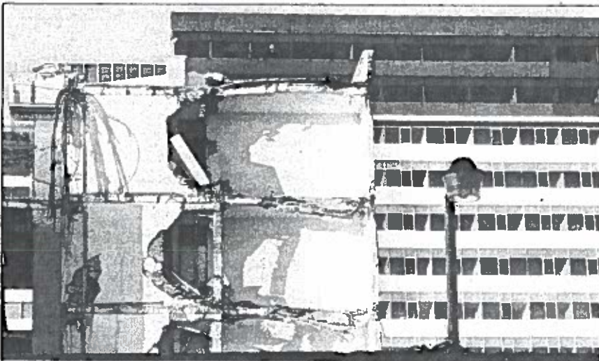
Autoridades de la delegación Benito Juárez informaron que se inició la demolición del edificio de la calle Emiliano Zapata número 56, en la colonia Portales, el cual colapsó y dejó dos personas muertas durante el sismo del 19 de septiembre. Detallaron que los últimos dos niveles será derribados de manera manual ■ Foto José Antonio López
