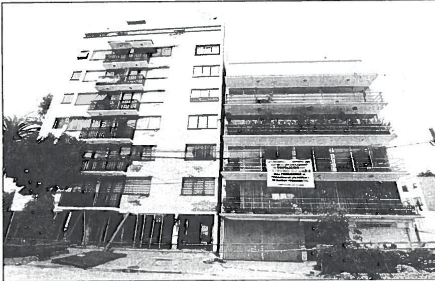
Imagen de dos edificios afectados por el movimiento telúrico del 19 de septiembre en la colonia Narvarte, los cuales fueron desocupados por sus habitantes por miedo a que caigan ■ Foto Carlos Ramos Mamahua
