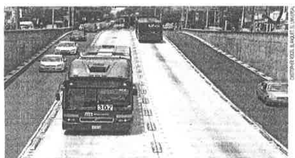
Se construirá una línea de Metrobús en Reforma, para lo cual se destinaron 249 millones 750 mil pesos, aunque la obra todavía no inicia.
