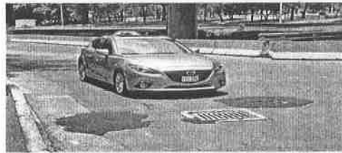
En un recorrido se detectó que los hoyos fueron reparados en ambos sentidos de la vialidad primaria.
