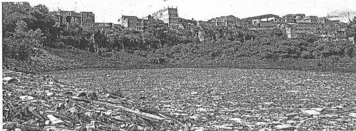
En la presa Becerra, en la delegación Álvaro Obregón, se acumulan en cada precipitación 30 toneladas de desechos que son arrastrados por escurrimientos.
