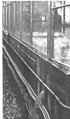
CHORROS de agua se metían por las paredes de la Línea A del Metro.
