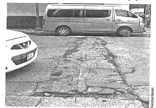
El asfalto en vialidades en Santa María La Ribera quedó dañado tras el retiro de topes para mejorar la movilidad.
