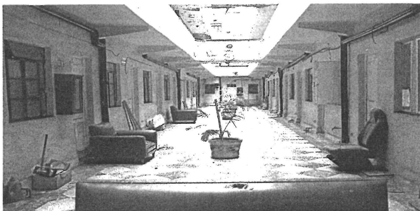
La arquitectura del inmueble data de 1950. De sus tres niveles, sólo el segundo y el tercero tendrán habitaciones. En la planta baja estará el comedor, oficinas administrativas y los consultorios de atención médica y psicológica.
