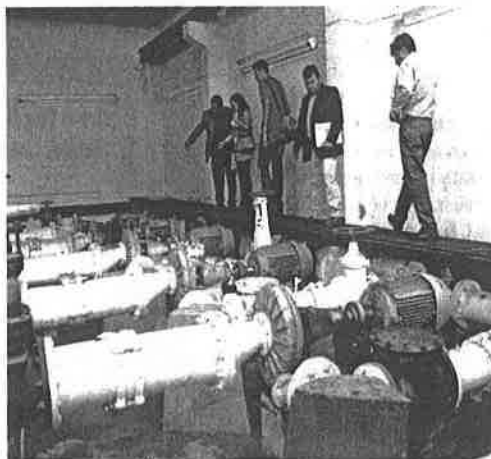
ALGUNAS TUBERÍAS están elaboradas con material cancerígeno, como asbesto y askarel
