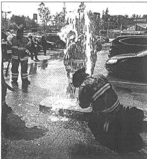
Una gran fuga de agua ocurrió en el estacionamiento del centro comercial Plaza Central, en el oriente de la ciudad. Bomberos intervinieron para controlarla y evitar que se desperdiciara más líquido ■ Foto Alfredo Domínguez
