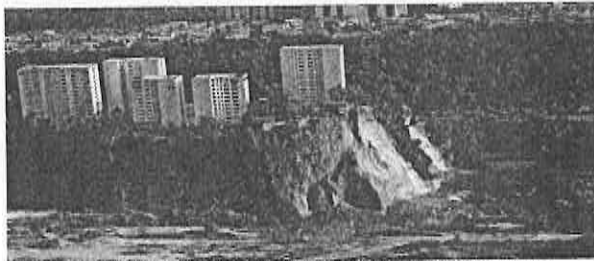
El requerimiento de la delegación plantea, además de la demolición de la vivienda de Rosette, construir un sistema de estabilidad y de anclaje del talud.
