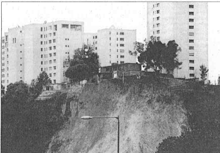
La vivienda que un particular edificó sin los permisos correspondientes quedó prácticamente al borde del precipicio tras los deslaves ocurridos en la colonia Prados de la Montaña, en Santa Fe ■ Foto Carlos Ramos Mamahua
