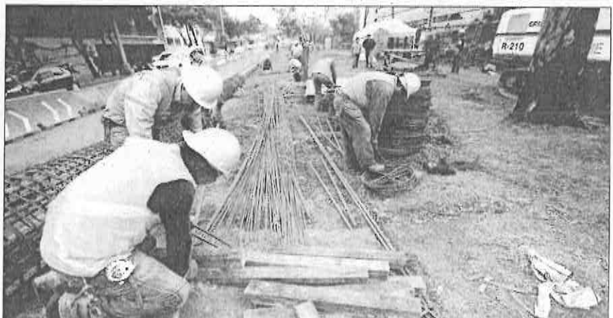
Trabajadores comenzaron muy temprano la construcción del túnel, después de dos días de guardias que efectuaron habitantes de la zona para evitar la edificación ■ Fotos Carlos Ramos Mamahua
