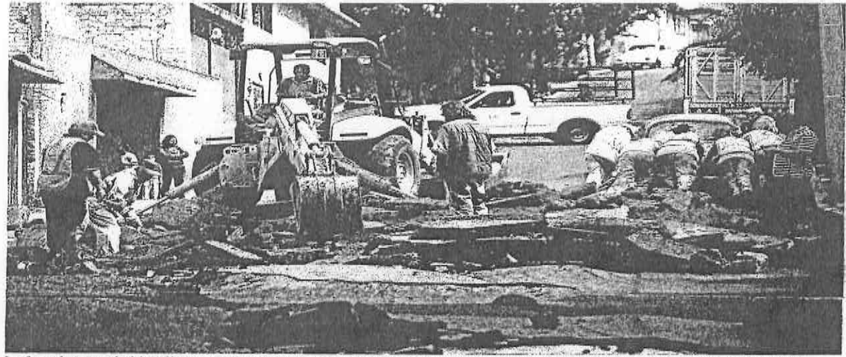
Las fugas de agua en la delegación Gustavo A. Madero provocan que se rompa el pavimento de la calle Miguel Bernal en la colonia Compositores Mexicanos.
