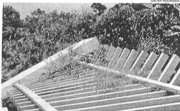
La reja perimetral se venció.
