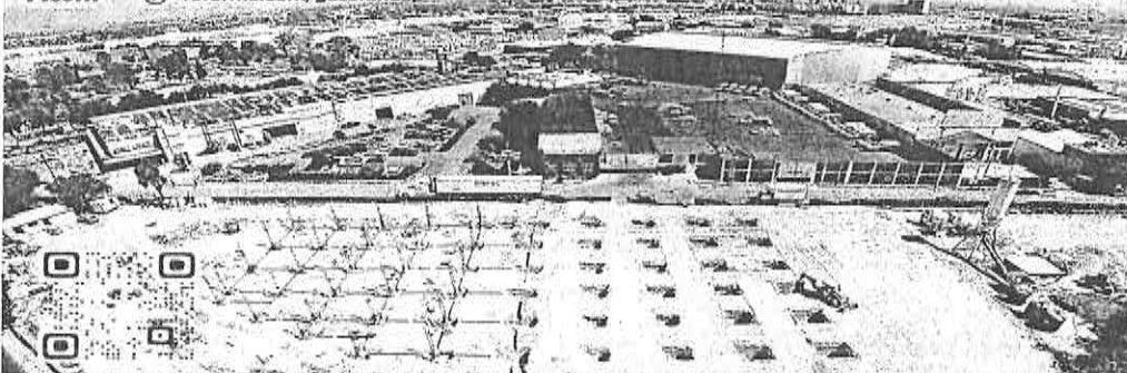
Los cimientos del nuevo Hospital General de Izcaltli están a tan sólo 10 metros de una gasera pesa a que la distancia mínima debe ser de 100 metros, de acuerdo con una Norma Oficial Mexicana.
