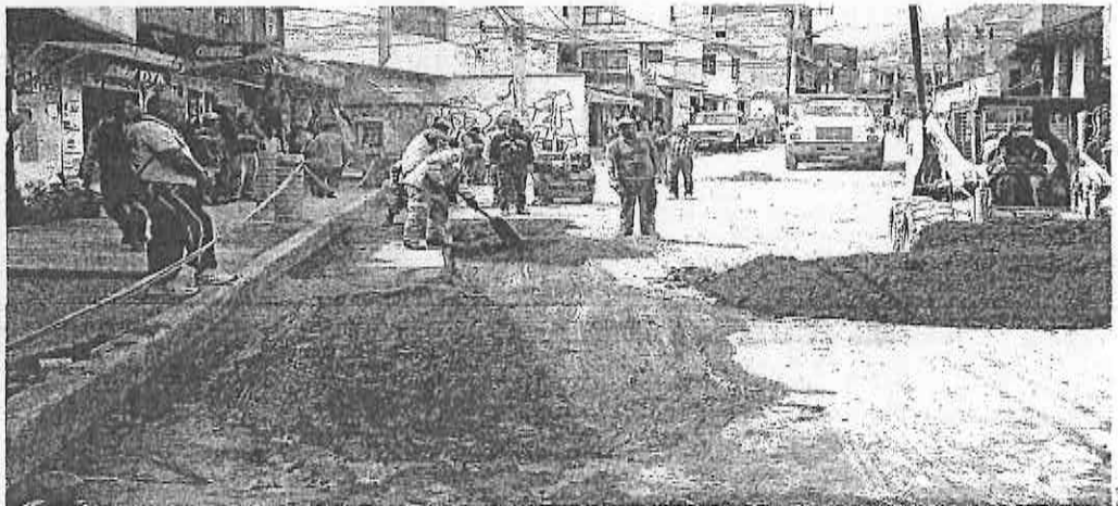
TRAS LA FUGA. La avería de agua potable que duró 55 horas fue provocada por trabajos de la empresa Gas Natural Fenosa. Unos 80 trabajadores del Sistema de Aguas y la Delegación trabajaron en la reparación que dejó a ocho colonias sin suministro.
