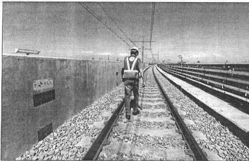
El secretario de Obras, Alfredo Hernández, dio a conocer pormenores de los trabajos de reparación en el tramo elevado de la línea 12 de Metro ■ Foto Alfredo Domínguez
