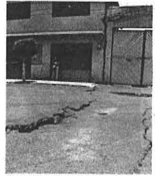
Al menos 71 fisuras se encuentran en 40 colonias de la demarcación.
