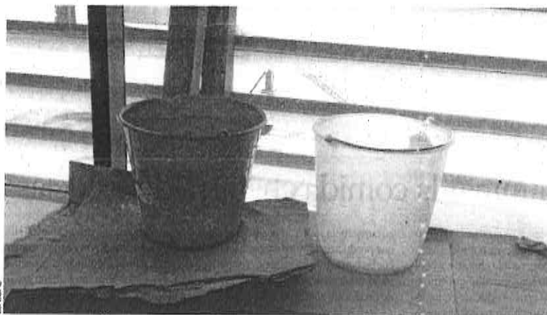
Entre goteras y cubetas, el Aeropuerto Internacional de la Ciudad de México da la bienvenida a los turistas que visitan la capital del país. El 5 de octubre pasado, la Terminal 2 reportó filtración de agua tras la intensa lluvia que se registró en el Distrito Federal
