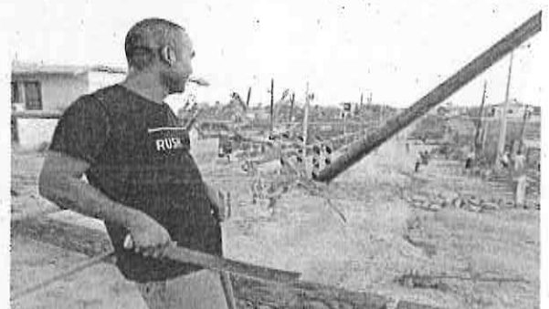
La población ayudó a cortar postes derribados por el viento.
