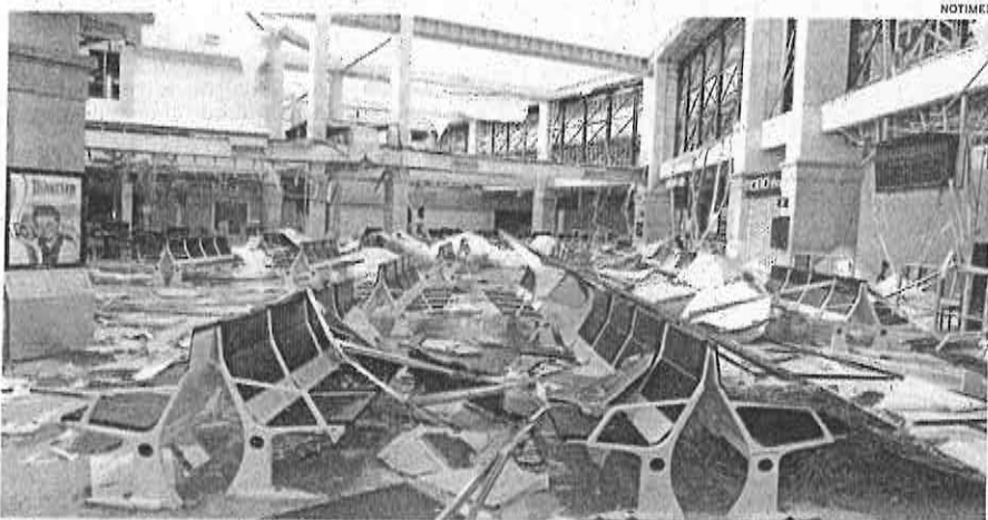
Daños provocados por el fenómeno en el aeropuerto de Los Cabos.
