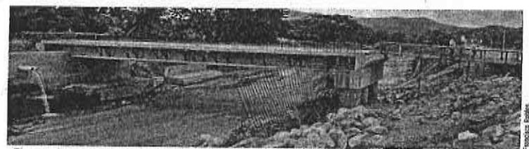
El puente ubicado cerca de la unidad habitacional San Agustín, en Acapulco, es una de las obras que no han podido ser terminadas a causa de las extorsiones, denuncia la CMIC.
