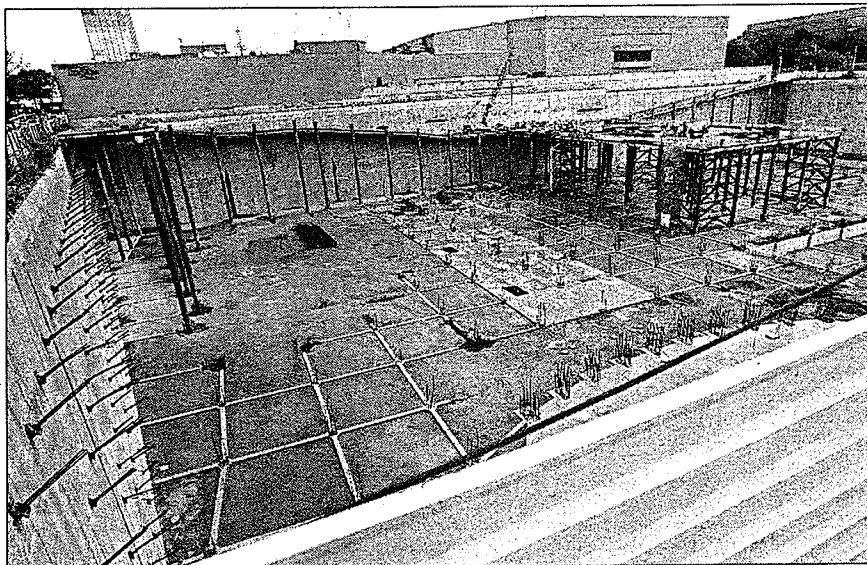
Vista de una de las áreas en construcción del complejo Ciudad Progressiva, sobre Río Churubusco casi esquina con avenida Universidad
