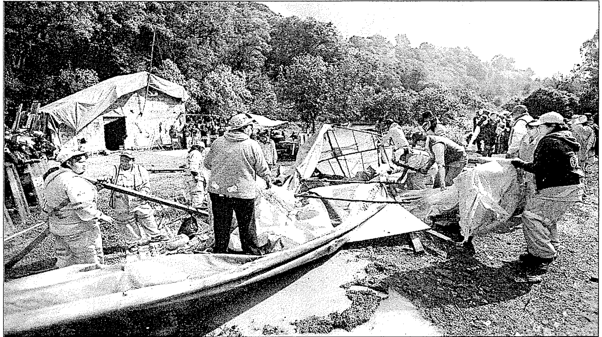
Las decenas de casas ubicadas en el paraje Pachuquilla estaban construidas con maderas, lonas, hules y láminas ■ Foto Alfredo Domínguez
