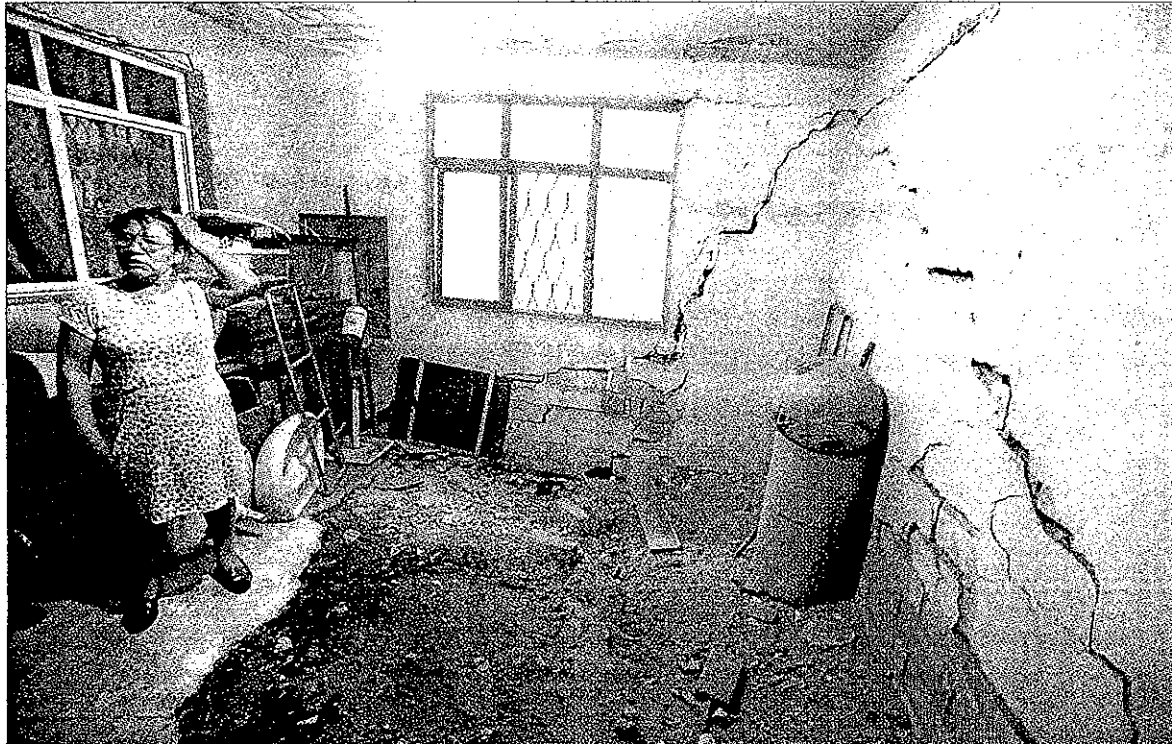
Agustina Ramírez señaló que en 2005 comenzaron los hundimientos y cuarteduras en su vivienda en Iztapalapa. Agregó que autoridades de protección civil rellenaron las grietas en 2009, pero éstas volvieron a aparecer ■ Foto Jesús Villaseca
