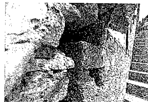
Aprendiendo a vivir con las grietas. (Fotos: Edgar López)
